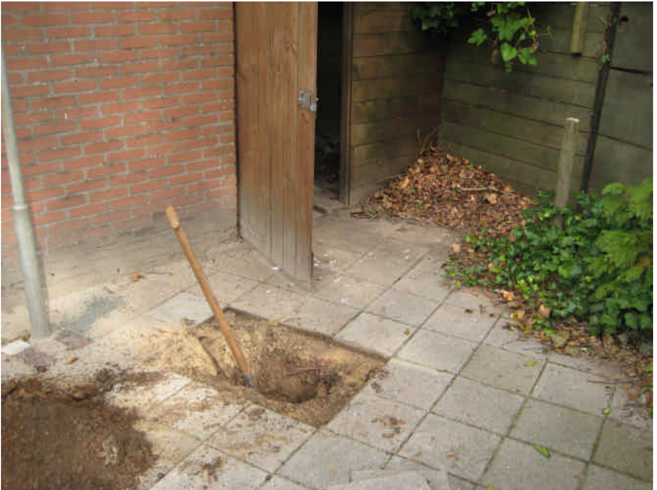
Foto 15: Onder de tegelverharding van het plaatsje achter het bijgebouw zijn wortels aangetroffen van de coniferen en de druif die hier werden aangeplant. Op bijna een halve meter diepte bevonden zich ook elektriciteitsleidingen in de grond. Het spitten is gestaakt, omdat dit onbeschermdde schemerlamp- en luidsprekersnoeren betrof.
