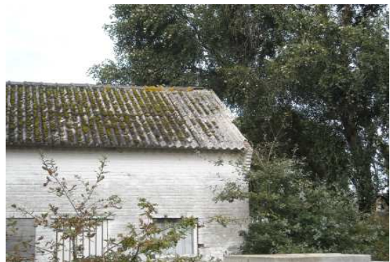
Foto 2: eërodeerde, (vermoedelijk) asbesthoudende golfplaten
