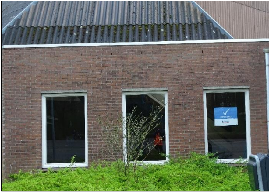
Foto 9. Open stootvoegen in de gevel van de sporthal aan de noordzijde.
