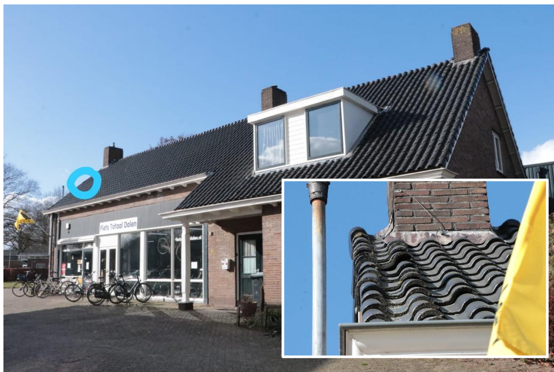
Figuur 3: Locatie van huismussennest. Inzet: close up van de betreffende losse dakpan.
