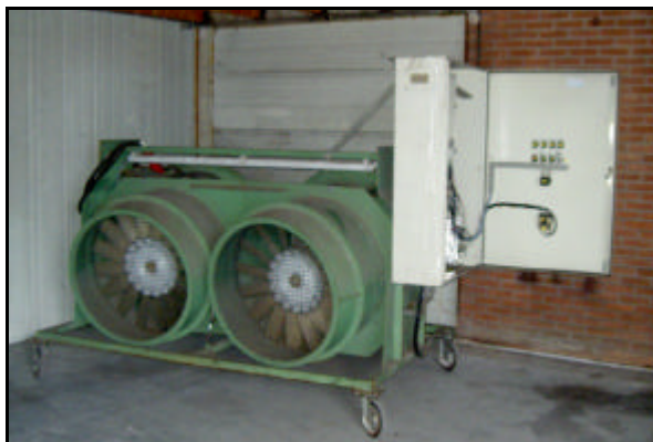
Afbeelding 3.1: ventilatoren t.b.v. koeling
