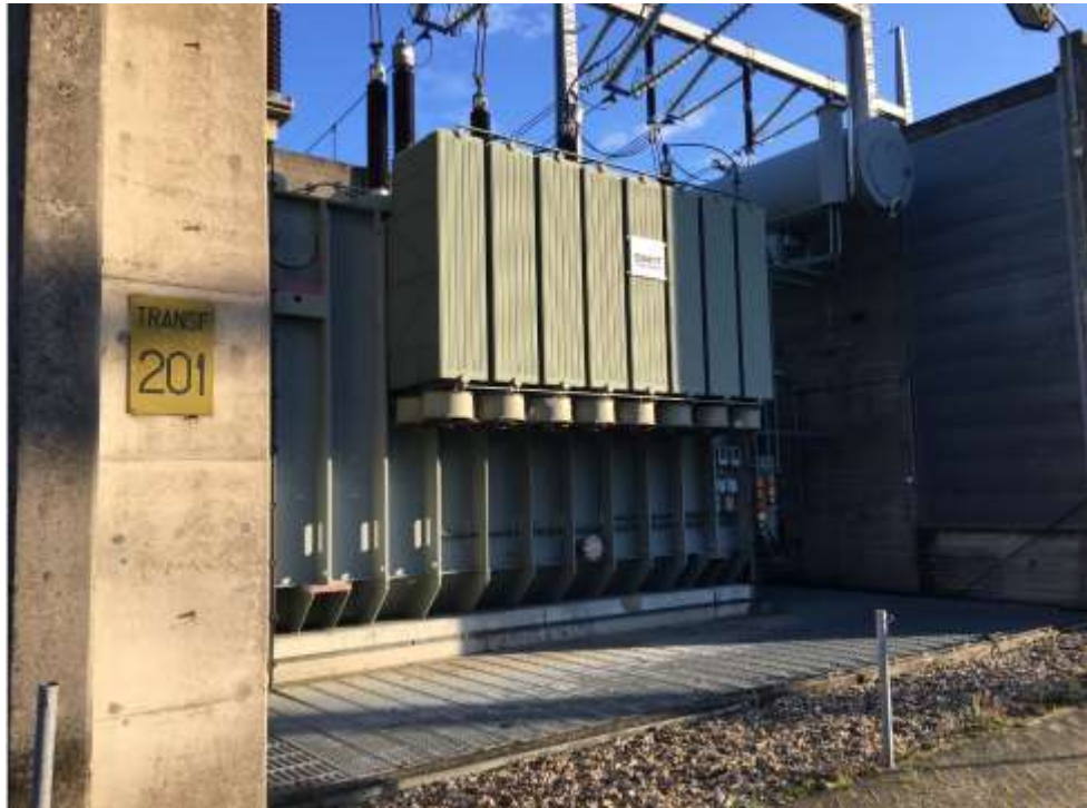
Figuur 4.5 Bestaande koppeltransformator in transformatorcel
