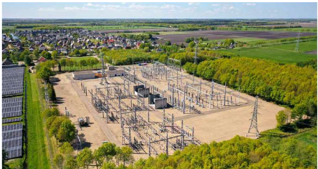
Figuur 3.2 Bovenaanzicht van het huidige transformatorstation Zeijerveen
