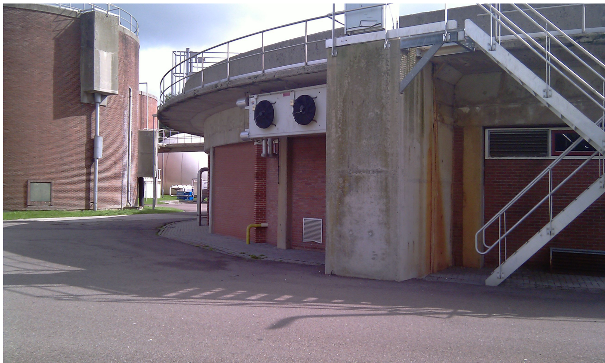
Afbeelding 2.4: overzicht luchtgekoelde condensors
