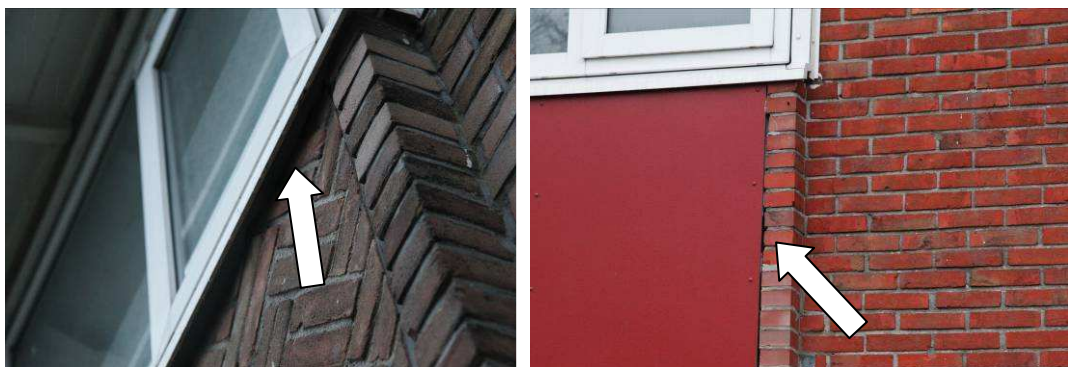
Figuur 3: Potentiële in- en uitvliegopeningen onder vensterbanken en op de gevels.
