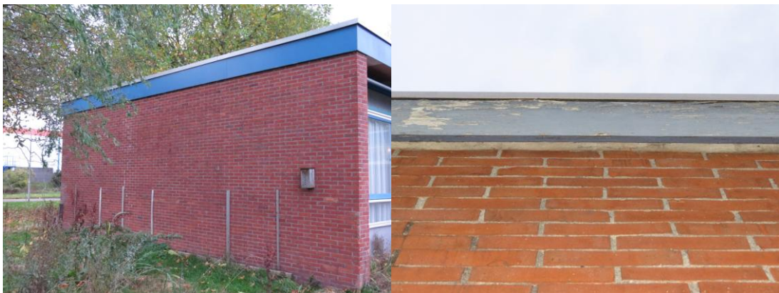
Foto 3 en 4. Spouwmuur zonder stootvoegen en ventilatieopeningen en een voorbeeld van sluitende boeidelen en daklijsten (foto's A&W 2014).
