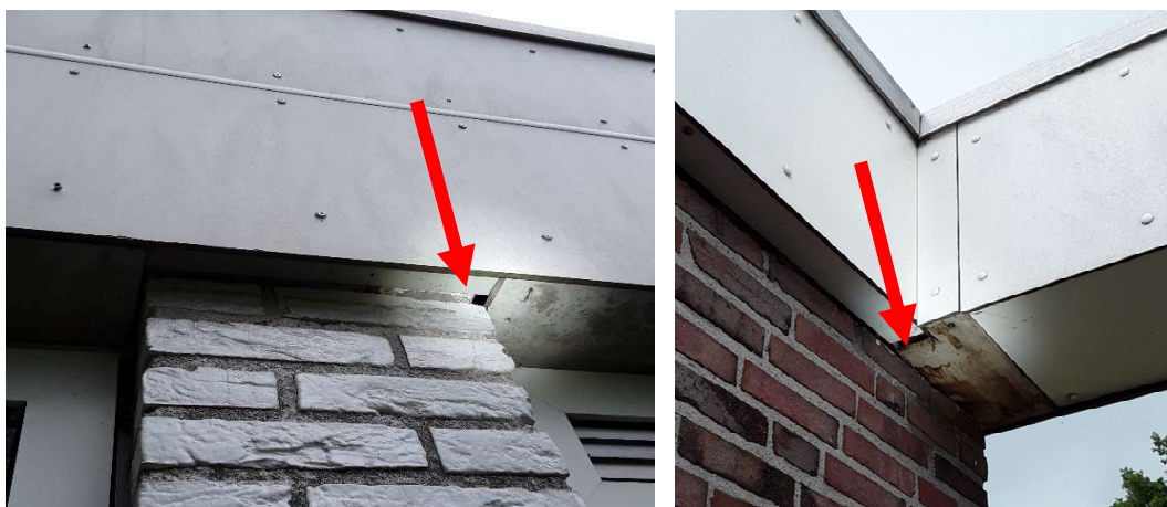
Foto 13 Voorbeelden van kieren in betimmering
