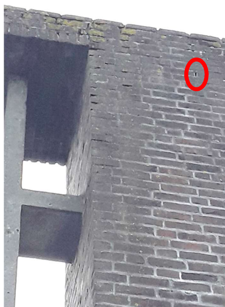
Foto 12 Mogelijk open stootvoeg in de klokkentoren
