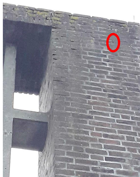
Foto 11 Mogelijk open stootvoeg in de klokkentoren
