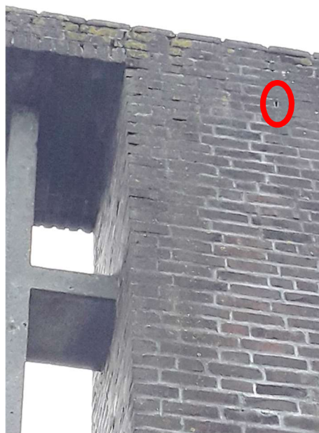
Foto 12 Mogelijk open stootvoeg in de klokkentoren
