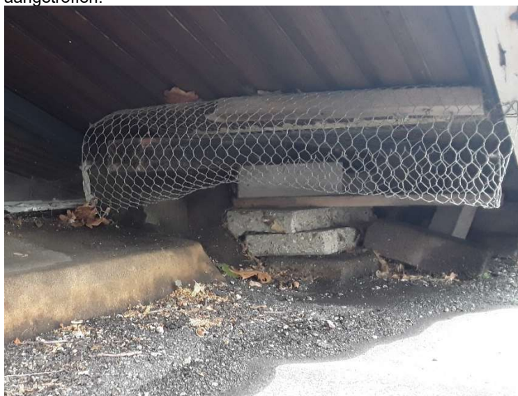
Foto 15 Voorbeeld van met gaas dichtgemaakte openingen op het dak tegen steenmarters
