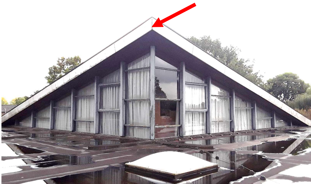
Foto 10 Kier in betimmering in de punt van het dak
