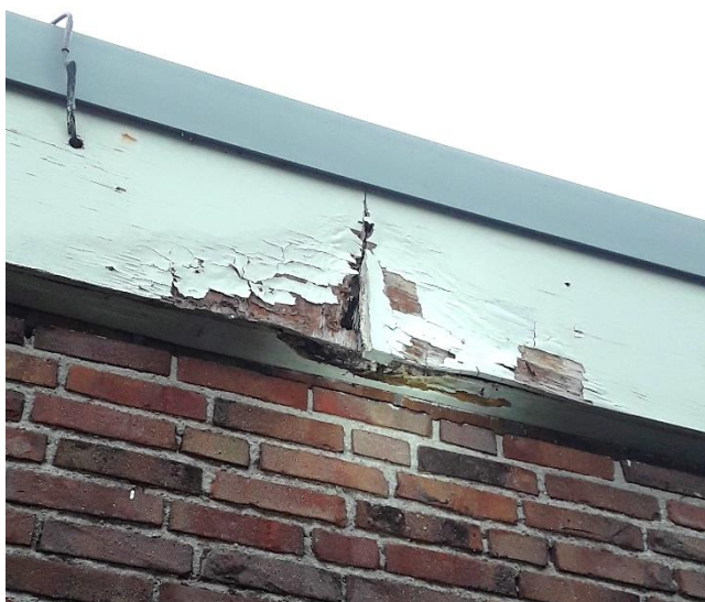
Foto 7 Opening in betimmering, tuinzijde
