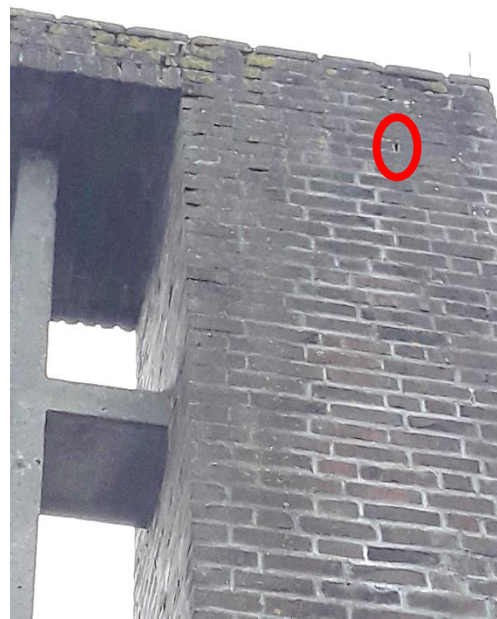
Foto 11 Mogelijk open stootvoeg in de klokkentoren
