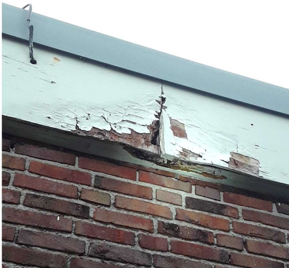
Foto 8 Opening in betimmering, tuinzijde
