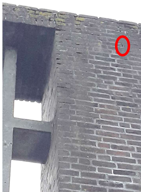
Foto 12 Mogelijk open stootvoeg in de klokkentoren
