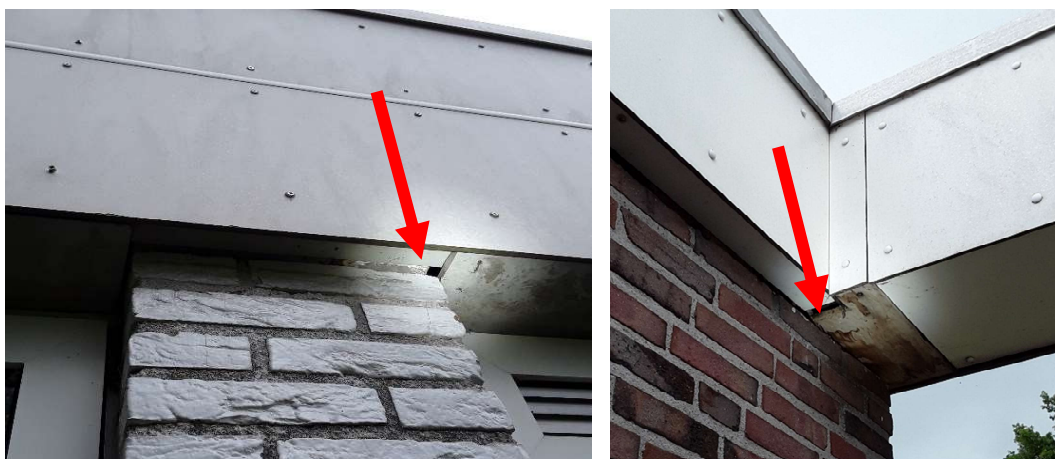
Foto 13 Voorbeelden van kieren in betimmering
