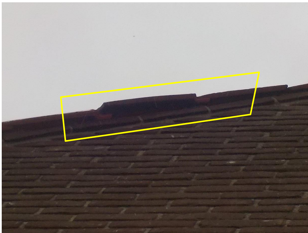
Foto 2 Scheefliggende gevelpan die gebruikt kunnen worden vleermuis verblijfplaats
