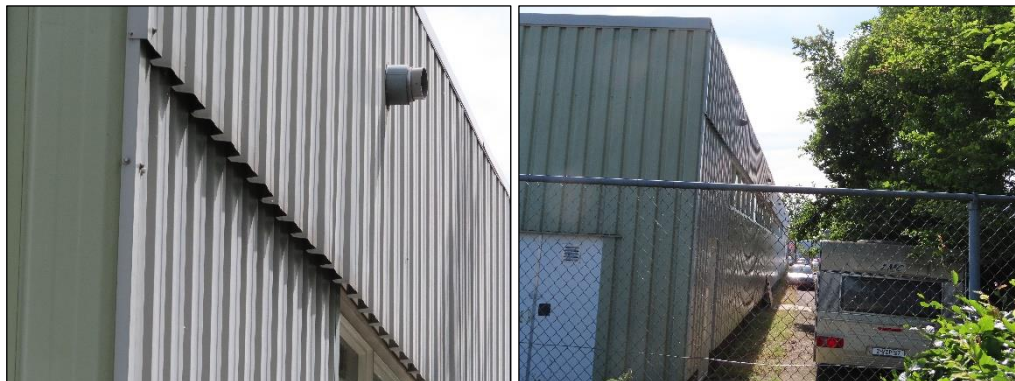
Figuur 4.2. Openingen tussen de wandplaten van de loods
