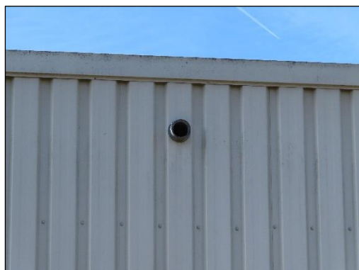
Figuur 4.3. Pijpjes aan buitenzijde van de loods.
