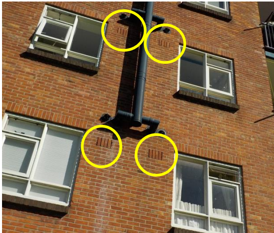
Figuur 7 Ventilatie roosters in de spouwmuur met een vrije aanvliegeroute die vleermuizen toegang kunnen bieden tot in de spouwmuur.
