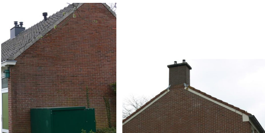
Figuur 3 Gevelpannen zijn niet toegankelijk voor Gierzwaluwen door betimmering of metselwerk.
