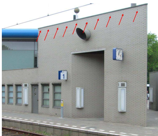
Figuur 3: Open stootvoegen in het stationsgebouw.
