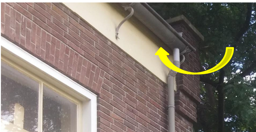
Figuur 6 Ruimte tussen de dakgoot en de muur van het schoolgebouw.
