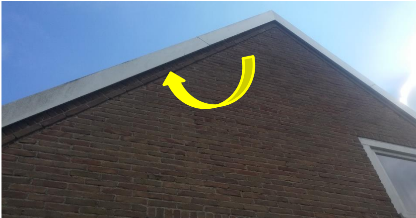
Figuur 7 Ruimte tussen de dakrand en de muur aan de kopse kant van een woning.
