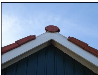
Figuur 6. Inspectie van het dakbeschoot onder de nokpan en de overhangende kantpannen.
