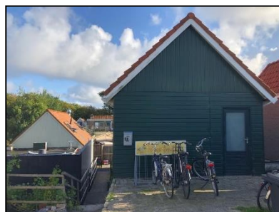
Figuur 4. Noordzijde van de onderzoekslocatie met overhangende kantpannen.
