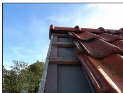
Figuur 7. Dakbeschoot onder de overhangende kantpannen.
