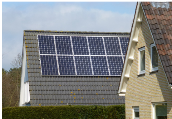
zonnepanelen op dak
