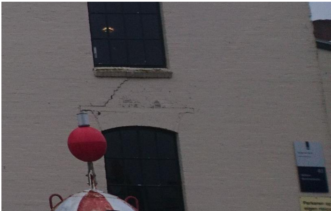
Figuur 4.2 Scheuren in de buitenmuren kunnen vleermuizen toegang verschaffen tot de spouw. Foto Ecogroen)
