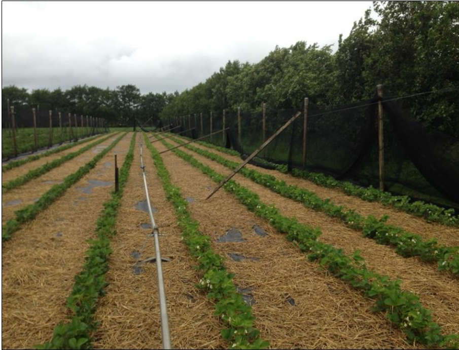
Figuur 15. Schade aan netconstructie
