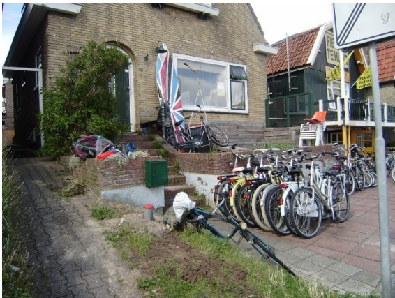
Foto 1. Willem Barentszkade 14 gezien van de weg. Vooraan het aflopend pad richting het binnenplaatsje, daar rechts van de trap en muur, die het hoogteverschil van circa 1,5 meter overbruggen.
