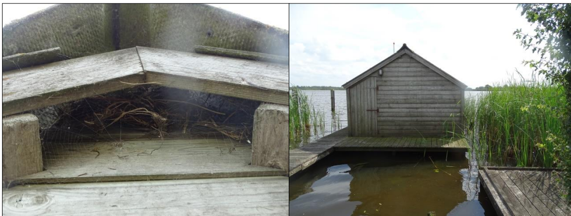
Foto 3 en 4. Links de nok van het schiphuis aan de noordzijde met een vogelnest. Rechts de noordzijde van het schiphuis vanuit het noorden.
