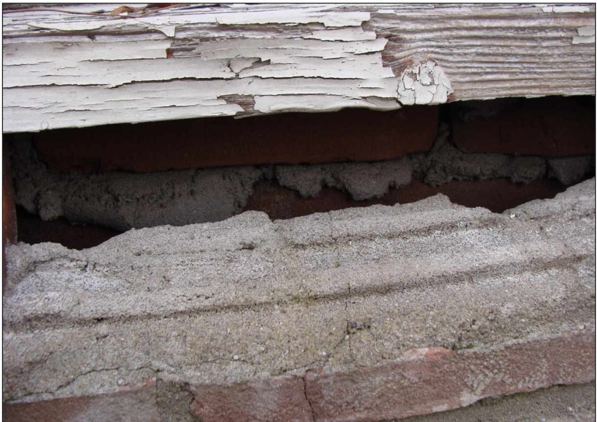
Figuur 5. Zichtbare open spouwmuur onder het raam uit figuur 5.
