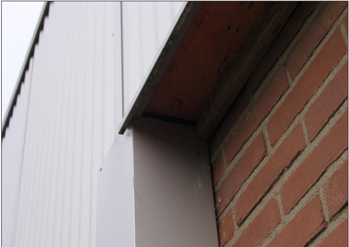
Figuur 7. Aan de westzijde is de ruimte tussen muur en beplating voor vlermuizen toegankelijk.
