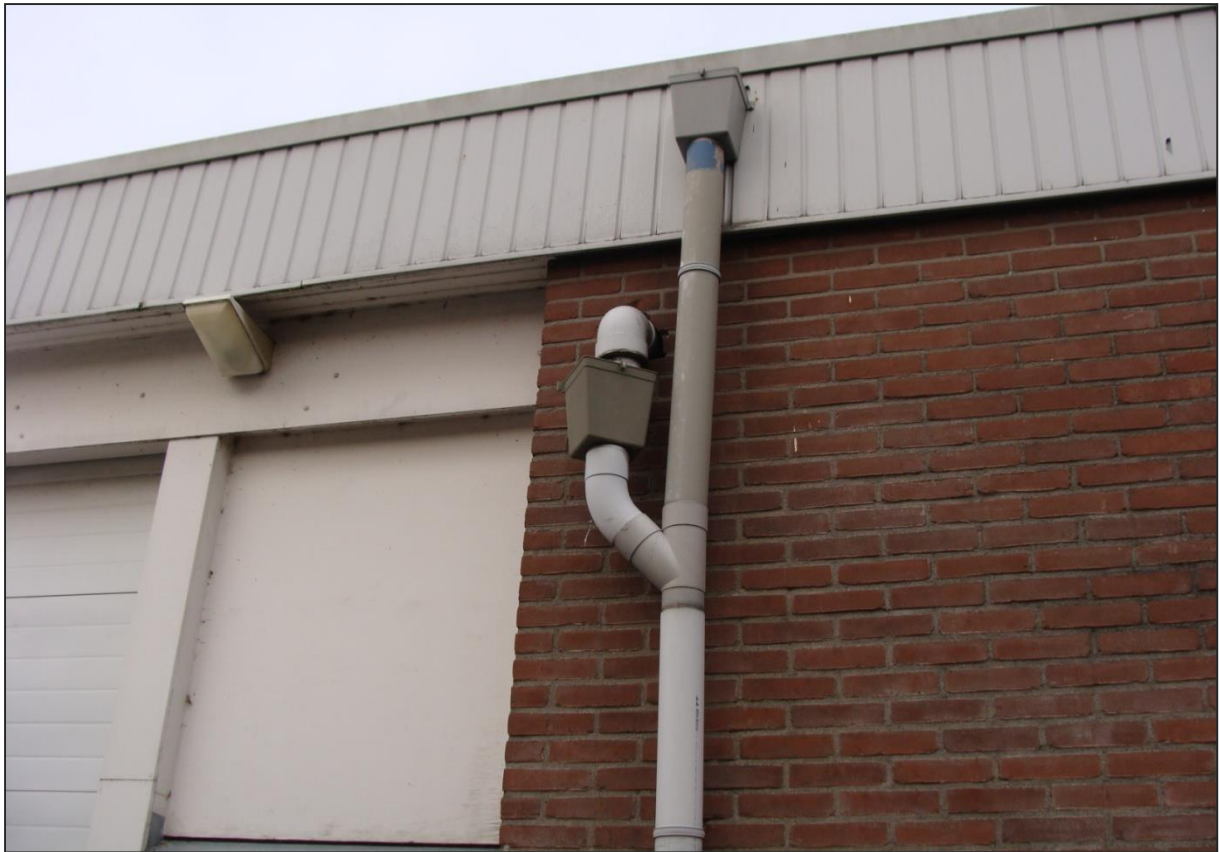
Figuur 6. De afvoerpijp aan de zuidzijde van het pand, met toegang tot de spouwmuur, maar waar direct naast een lamp aanwezig is.
