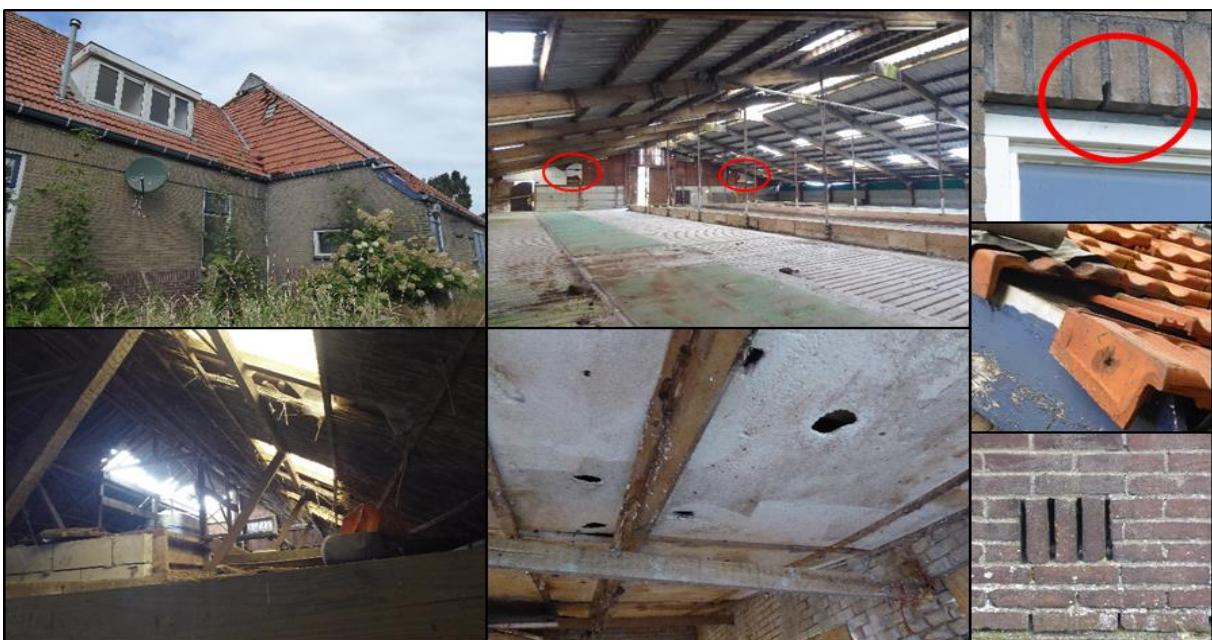
Figuur 2.5. Impressie mogelijkheden voor vleermuizen om binnen de bebouwing van het plangebied te verblijven.
