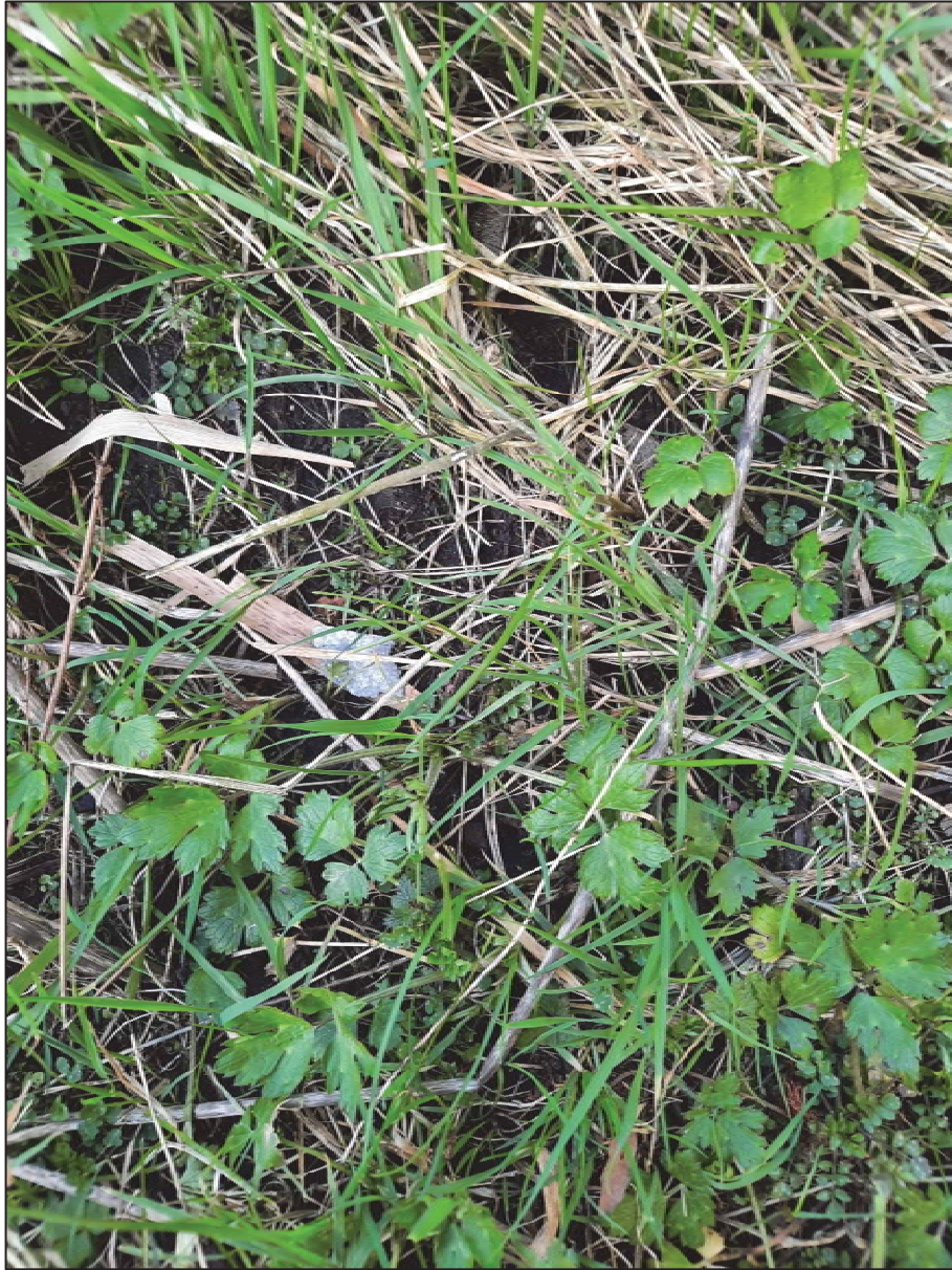
Asbesthoudend plaatmateriaal op maaiveld tussen silo en schuur
