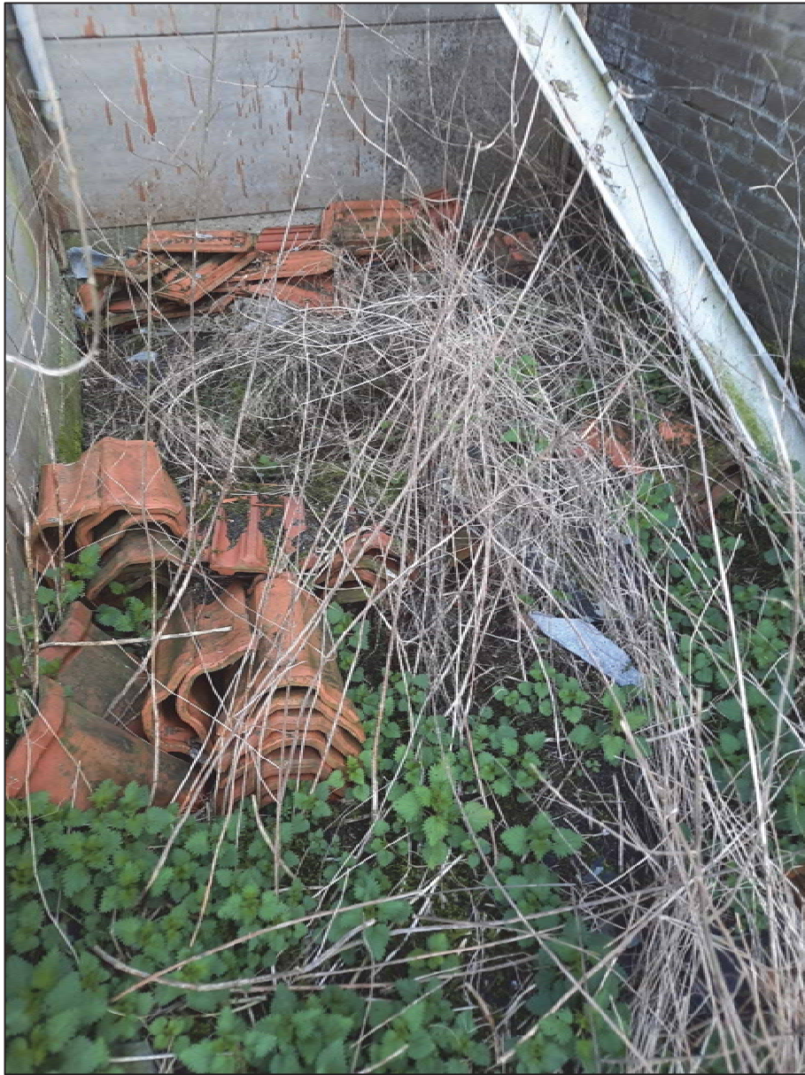
Asbesthoudend plaatmateriaal op maaiveld
