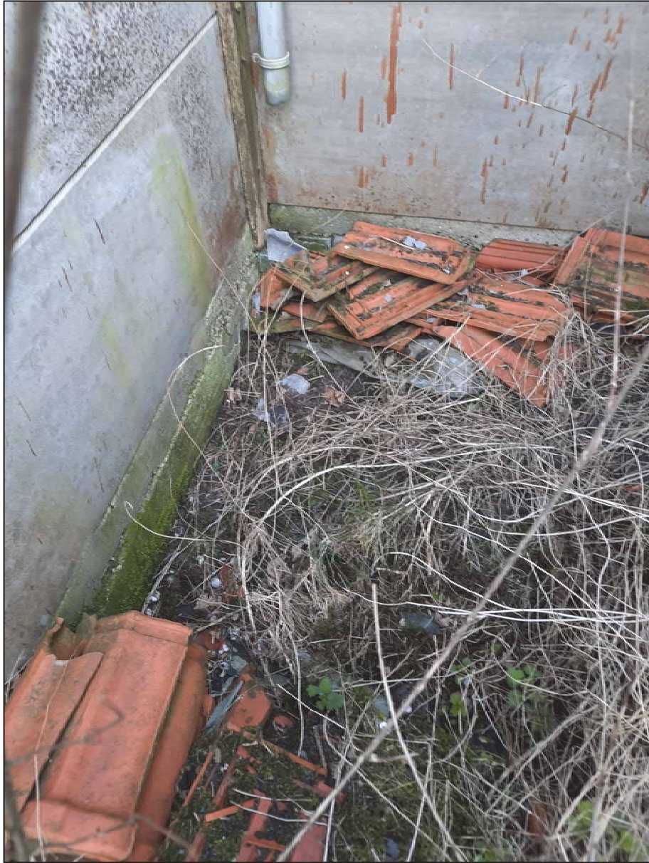
Asbesthoudend plaatmateriaal op maaiveld
