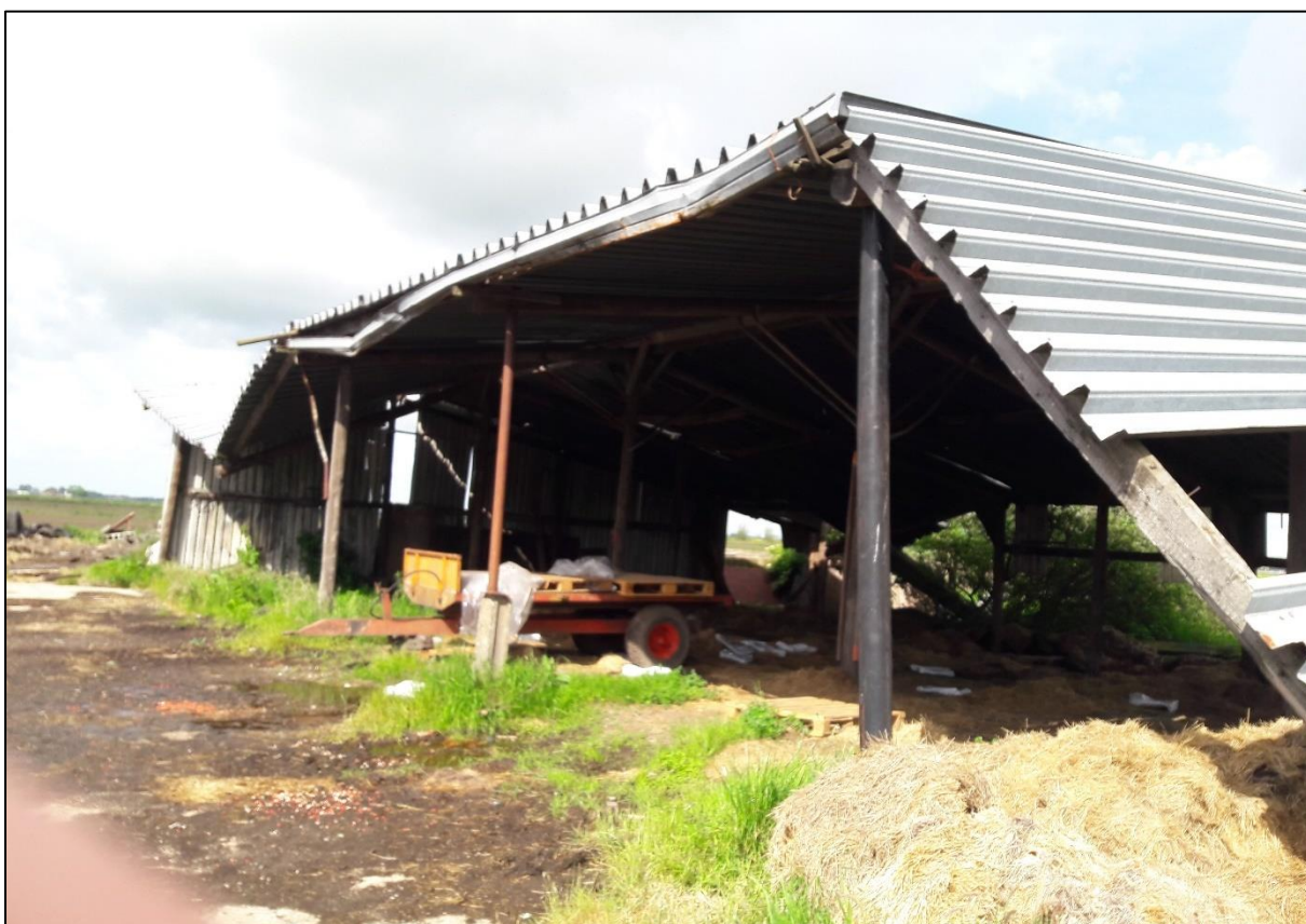
Figuur 4. Half ingestorte open schuur achterop het terrein
