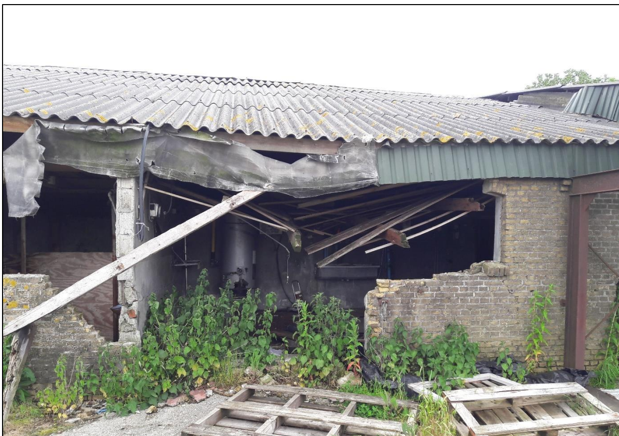
Figuur 7. Stal tussen de grote melkvee stal en grote schuur, waarvan de dakconstructie vergaan is
