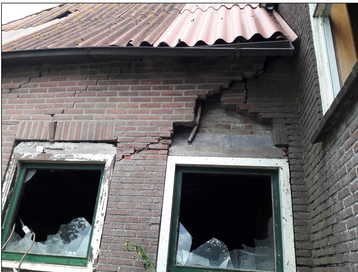
Figuur 6. Verzakte en gescheurde muur van de grote schuur tegen het voormalige woonhuis aan
