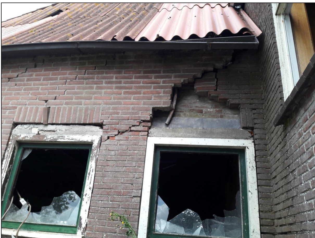
Figuur 8. Verzakte en gescheurde muur van de grote schuur tegen het voormalige woonhuis aan
