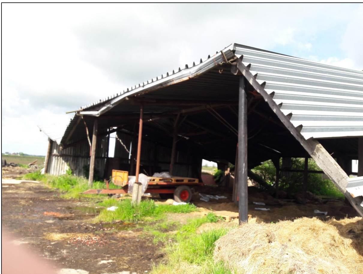
Figuur 3. Half ingestorte open schuur achterop het terrein
