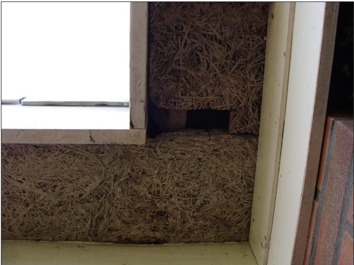
Figuur 11. Spleten in de dakbedekking van het clubhuis. Onder één van deze spleten zijn sporen van vleermuizen waargenomen.
