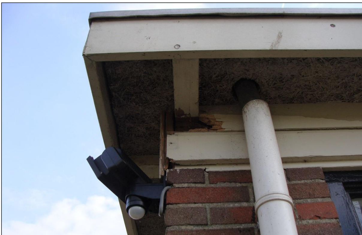
Figuur 12. Aangetast houtwerk in de dakconstructie van het clubhuis (achterzijde).
