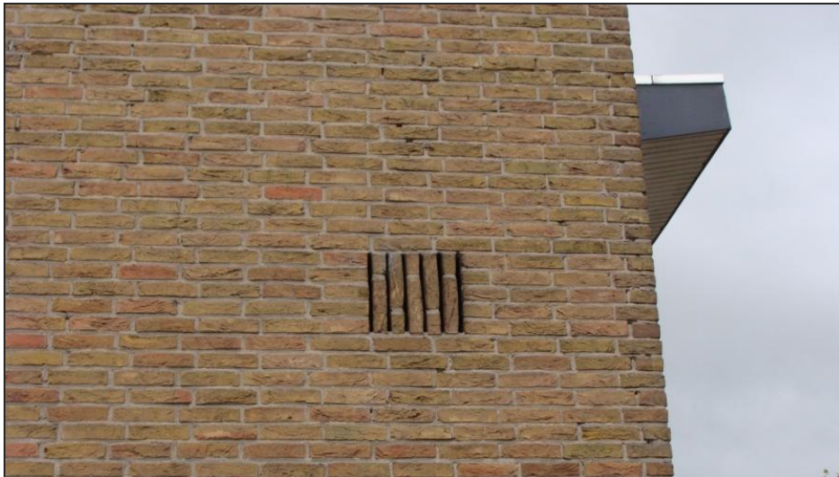
Figuur 5. Open voegen aan de voorzijde van het pand van de voormalig Frieslandbank (rechter blok aan zijde Hofland).
