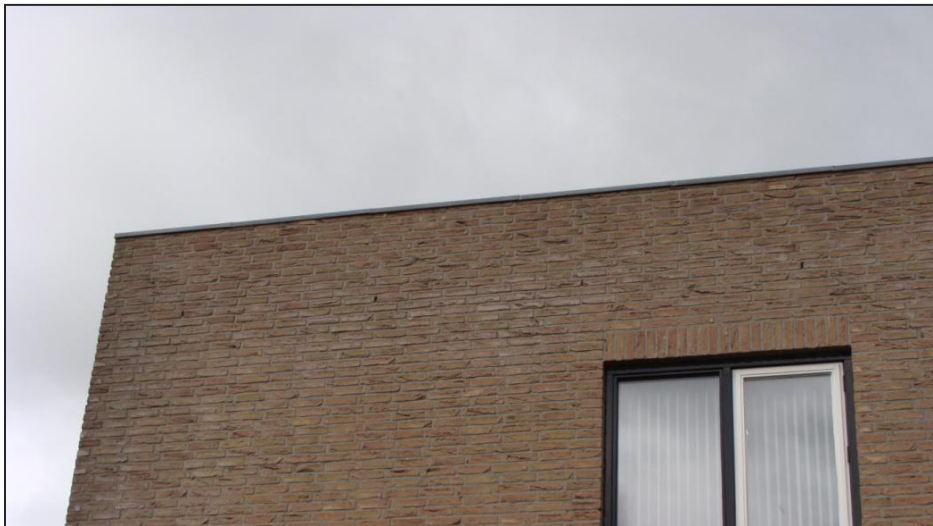
Figuur 4. Stootvoegen aan de voorzijde van het pand van de voormalig Frieslandbank (linker blok aan zijde Hofland).
