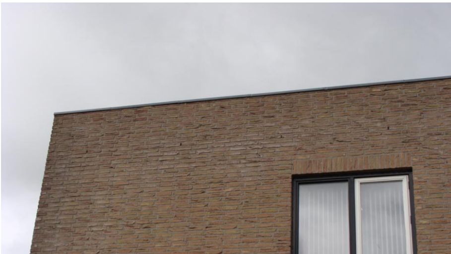
Figuur 4. Stootvoegen aan de voorzijde van het pand (linker blok aan zijde Hofland).
