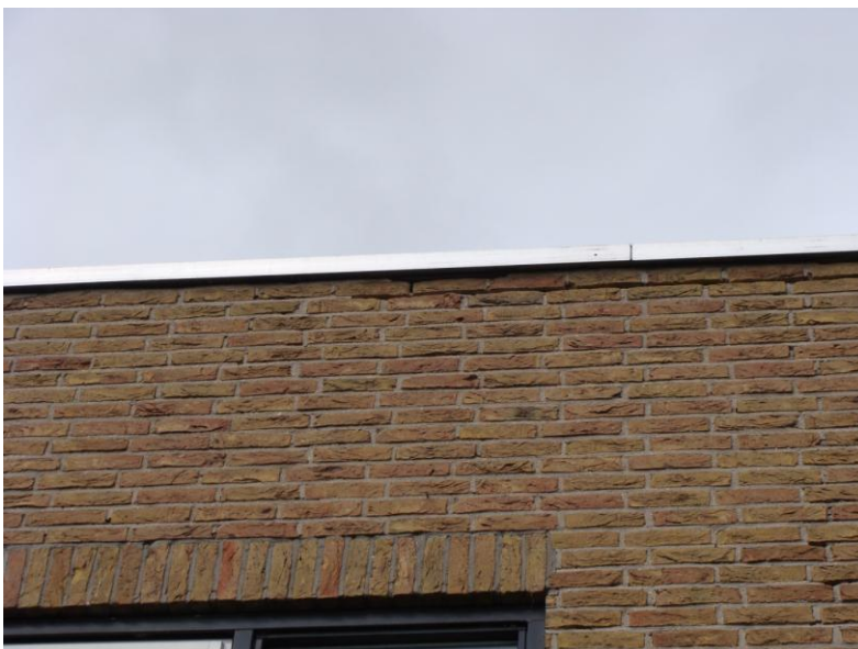
Figuur 7. Beschadigd metselwerk aan de voorzijde van het pand (zijde Hofland).
