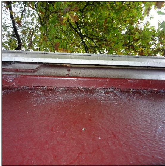
Afbeelding 3.5. Ruimte tussen gevelplaten (bijgebouw).
