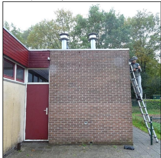
Afbeelding 3.4. Open stootvoegen in metselwerk (kantine).
