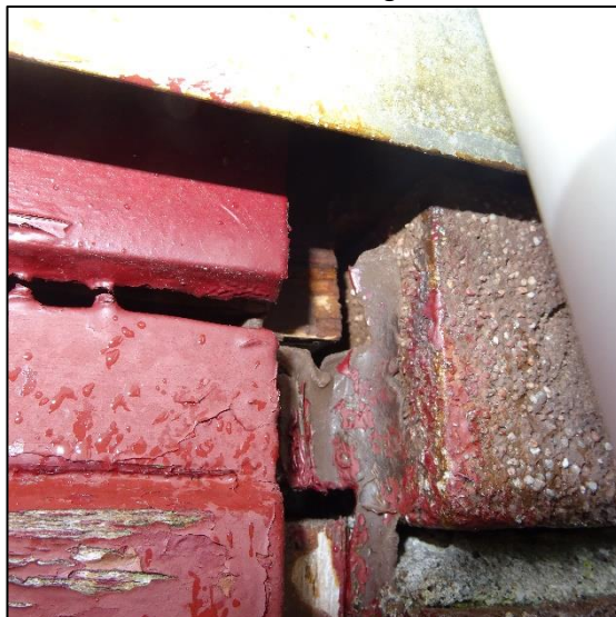
Afbeelding 3.3. Ruimte tussen metselwerk en boeiboord (kantine).
