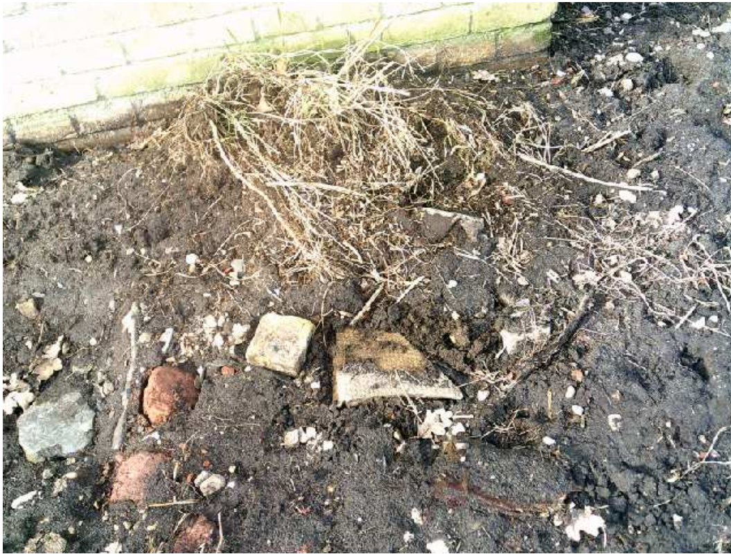
Foto 15. Wester Es 48, Appelscha asbestverdachte materiaal op maaiveld
