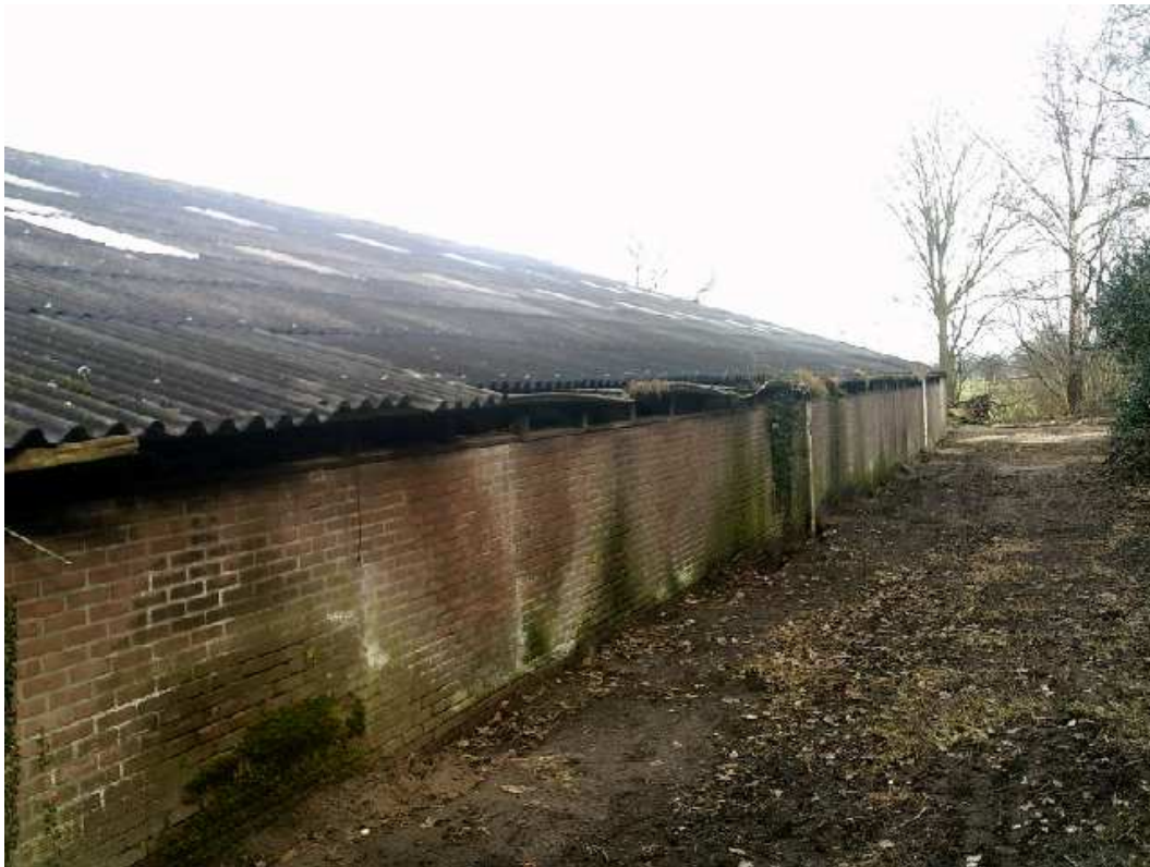
Foto 8. Wester Es 48, Appelscha asbestverdachte daken zonder deugdelijke goot
