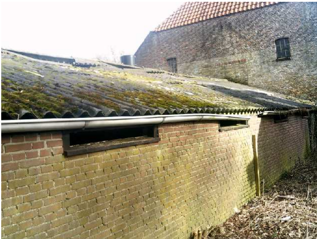
Foto 20. Wester Es 48, Appelscha asbestverdachte daken zonder deugdelijke goot
