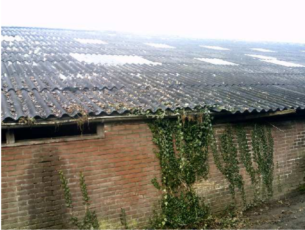
Foto 7. Wester Es 48, Appelscha asbestverdachte daken zonder deugdelijke goot
