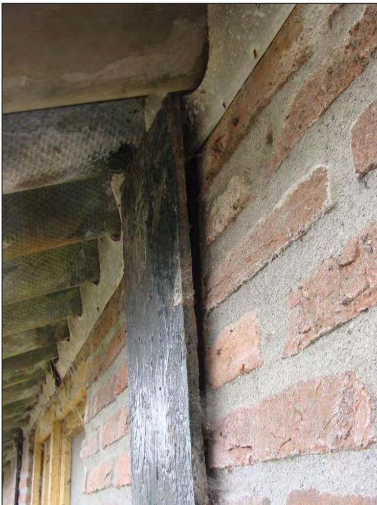
Figuur 9. Eén van de gevelplanken van de noordelijke varkensstal, met ruimte voor vleermuizen erachter.
