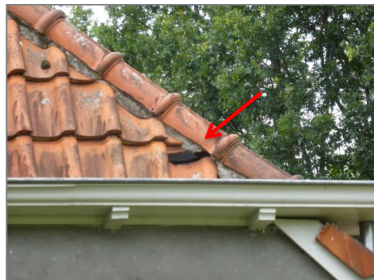
Figuur 4.12. kapotte dakpan van schuur aan het woonhuis
