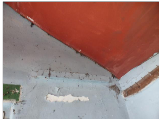
Figuur 4.6. vleermuisuitwerpselen uit plafond in bijgebouw
