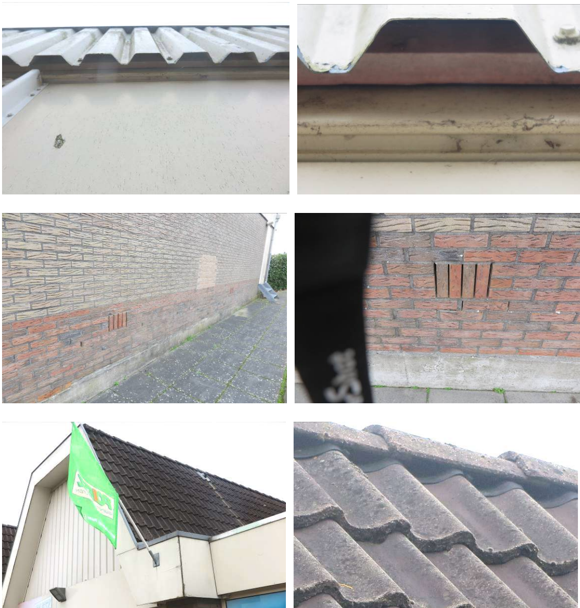
Figuur 3. Geen toegang voor vleermuizen en vogels door ontbreken geschikte openingen; boven; rand en golfplaten waar het te heet achter wordt, midden; te lage en te kleine openingen, onder; volledig dicht dak.
