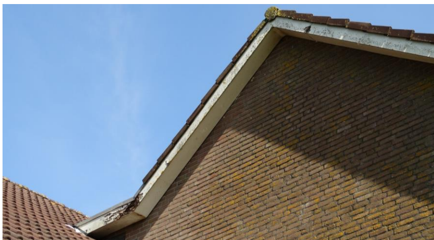
Figuur 5-09. Links onderin en rechtsboven zijn gaten in het dakbeschot zichtbaar. (Foto: M. Zweemer).
