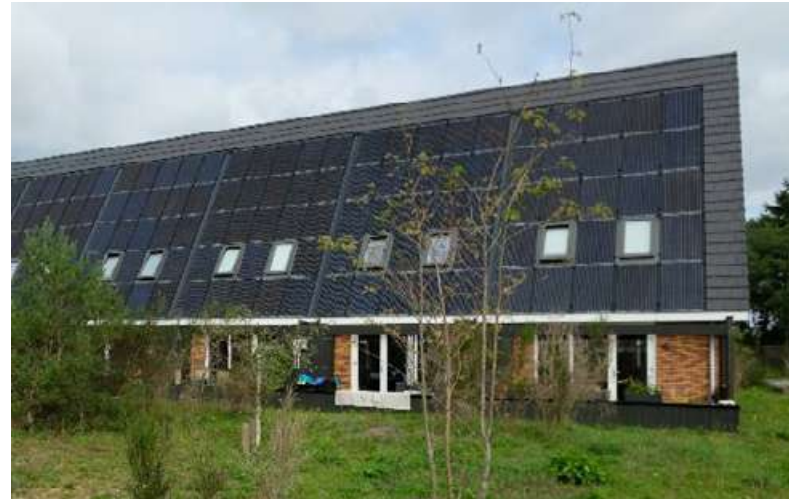
PV-panelen toepasassen op daken en mobiliteitshubs
