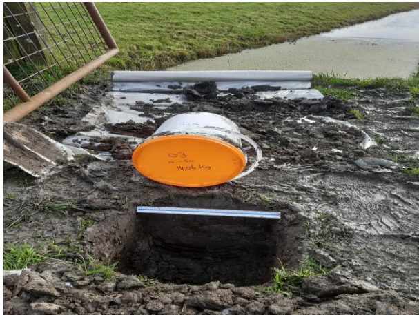
Fotonummer: 3 Omschrijving: Gat 03
