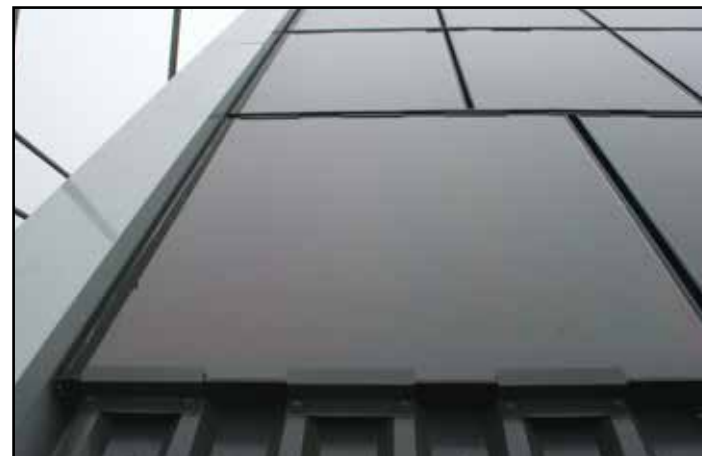
PV-panelen geïntegreerd in het dak
