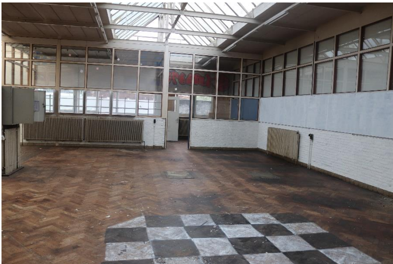
Figuur 4: (Smeer)olieachtige substantie (noordwestzijde voormalig schoolgebouw)
