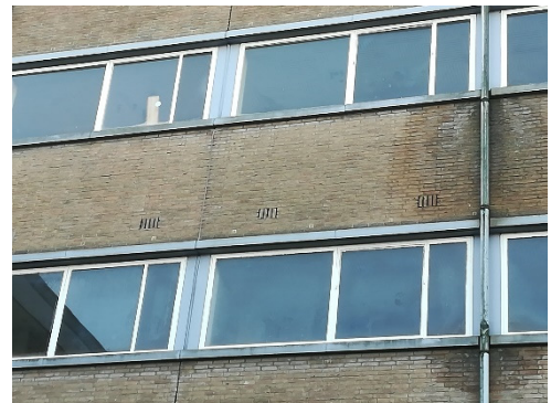
Foto 8: spouwmuur met open stootvoegen
