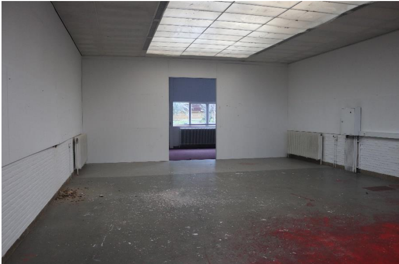
Figuur 3: Resten verf op betonvloer (noordwestzijde voormalig)
