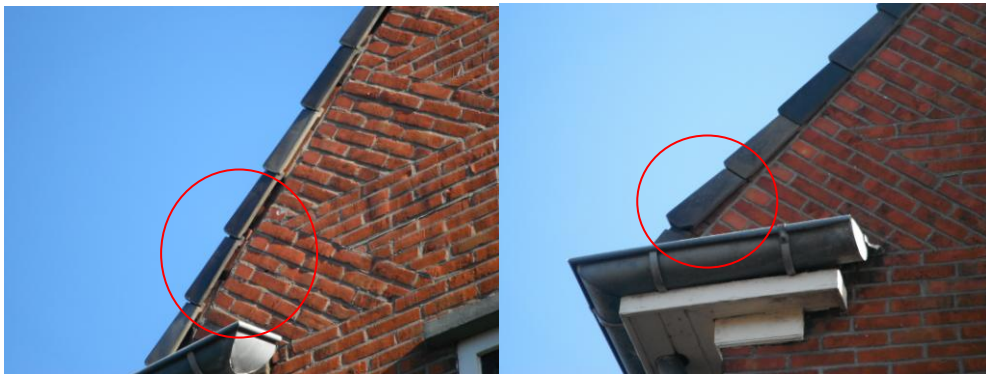
Foto 5 en 6 (foto's A&W 2014) Voorbeelden waarbij de dakrand toegang biedt voor (Meer)vleermuizen tot de spouw.
