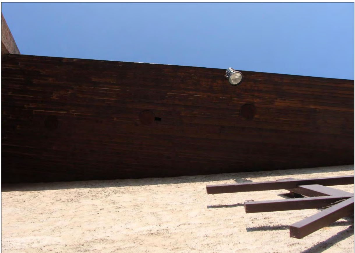
Figuur 7. Opening in de houten daklijst.
