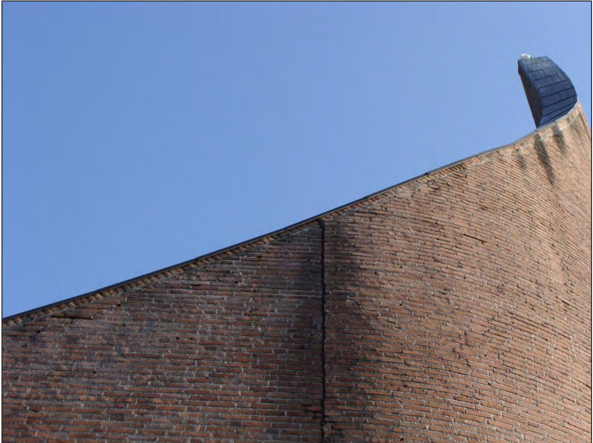
Figuur 6. Lengtescheur in de gevel van het gewelfde deel van het kerkgebouw.
