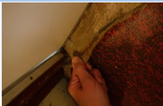
38 | Vloerzeil; geen asbest
