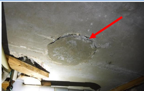
7 | Restant buismateriaal in begane grond vloer
