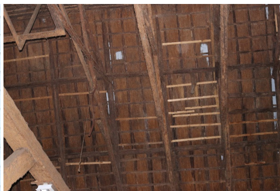
Foto 4: Plafond romp van de boerderij
