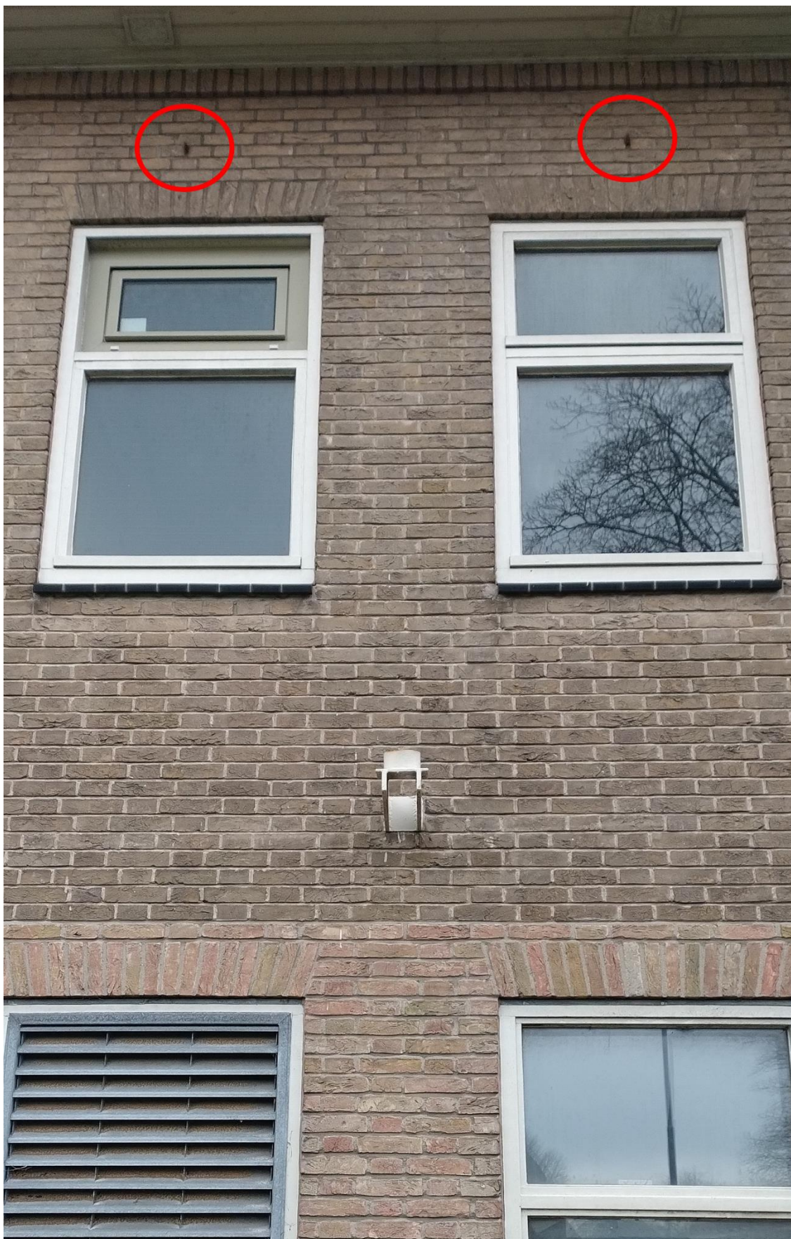
Figuur 2.2. Op enkele plekken werden stootvoegen aangetroffen, waardoor de spouwmuur van het complex toegankelijk is voor vleermuizen.
