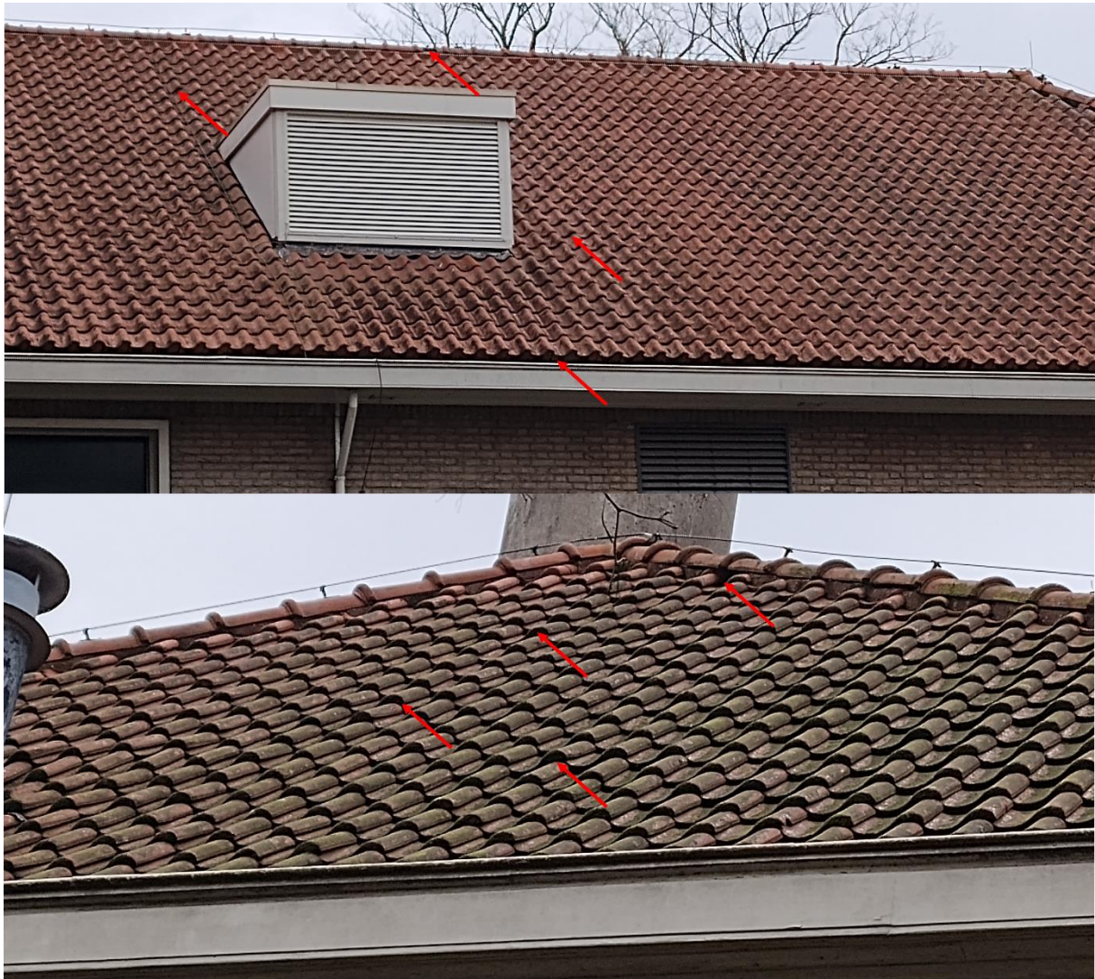
Figuur 2.1. Op verschillende plekken werden onder gegolfde dak- en nokpannen voor huismussen geschikt bevonden doorgangen aangetroffen.
