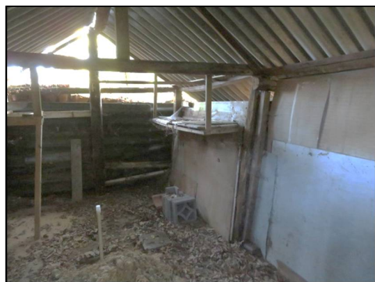
afbeelding 2.3. Binnenkant vervallen schuur.
