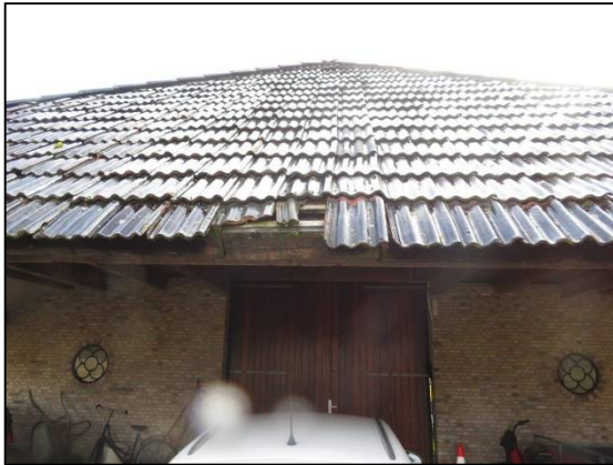
afbeelding 2.8. Schade aan het bijgebouw vanaf de westzijde.
