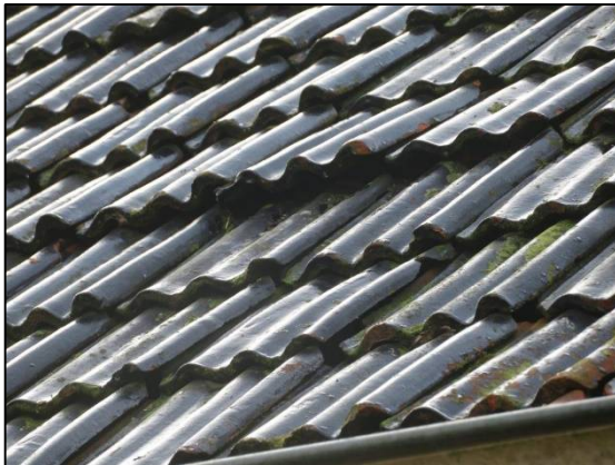
afbeelding 2.4. Losse dakpannen op de westelijke kap.
