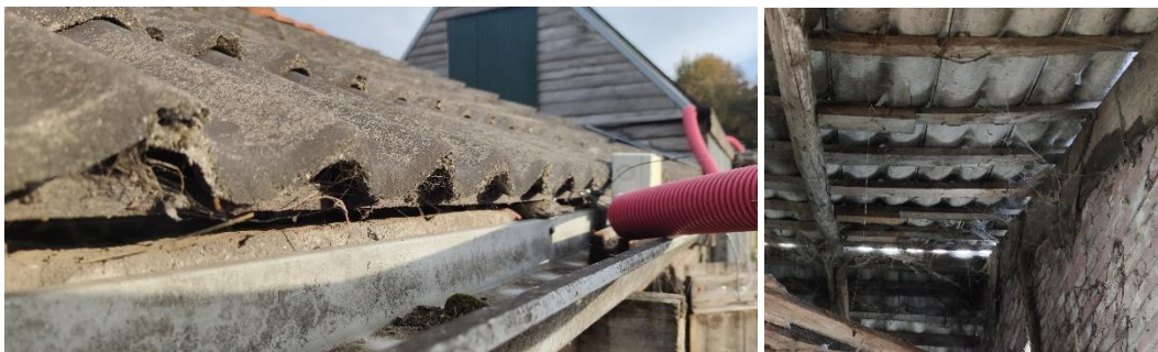
Figuur 5: links dakpannen vanaf de buitenkant en rechts een foto van de achterkant van de dakpannen
